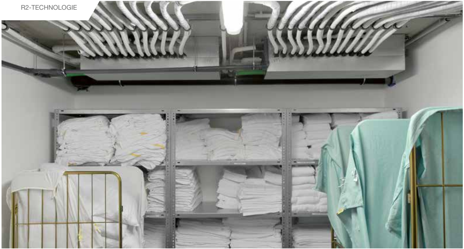
Nehmen keinen Platz weg: Die BC-Controller zur bedarfsgerechten Verteilung der Energie wurden einfach unter der Decke im Wäscheraum montiert.
